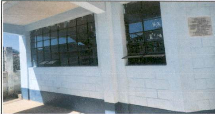
Foto 5: Aulas que necesitan varillas de hierro de metal
