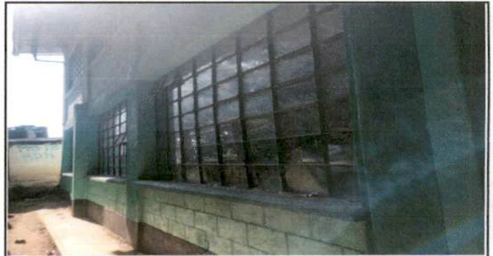
Foto 6: Situación actual de las ventanas, peronas entran a sacar cosas
